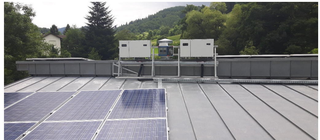
Installierte Wechselrichter zur Stromumwandlung
