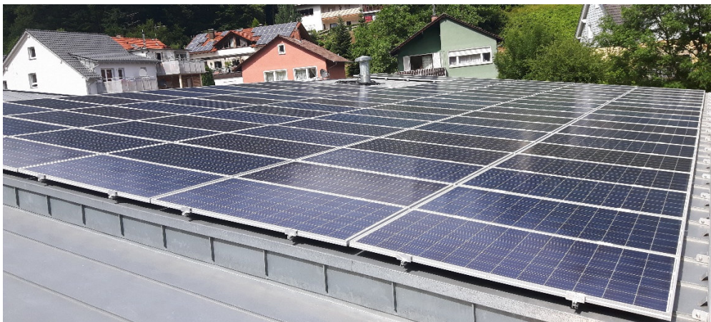
PV-Module auf dem Titanzinkblech-Stehfalzdach
